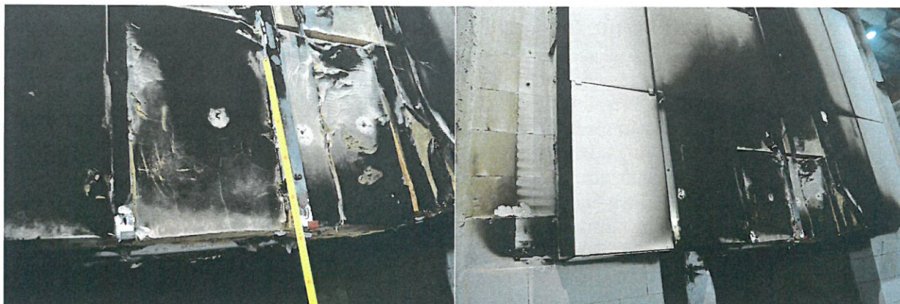
Rys. 27. Widok próbki po badaniu – detale, c.d.
