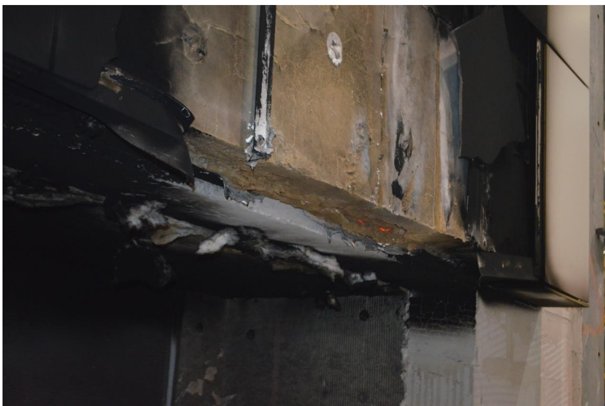
Rys. 13. Widok elementu próbnego po badaniu - data1
